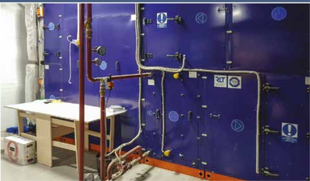
Склад «MARAT» Казахстан – установка с пластинчатым рекуператором
