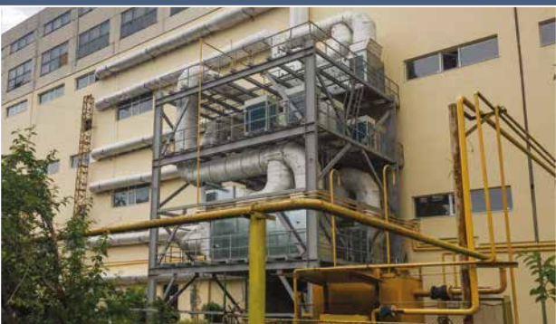
ТЦ «ALFA CITY» г. Кишинев Молдова – 4 шт газовых установок
