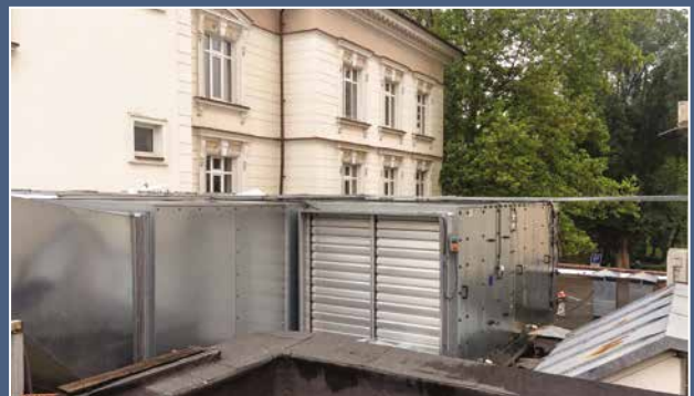
«DRIVE» г. Кишинев Молдова – установка с тепловым насосом расход воздуха 31 000 м³/ч
